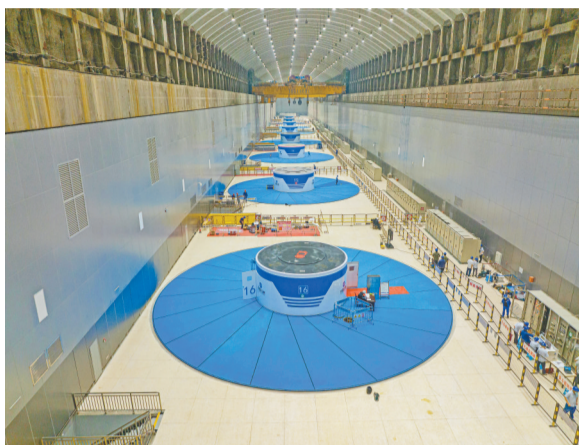
白鹤滩水电站右岸主厂房。 通讯员 谢雷 摄
